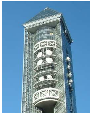
アンテナデッキに設置されたパラボラアンテナ
